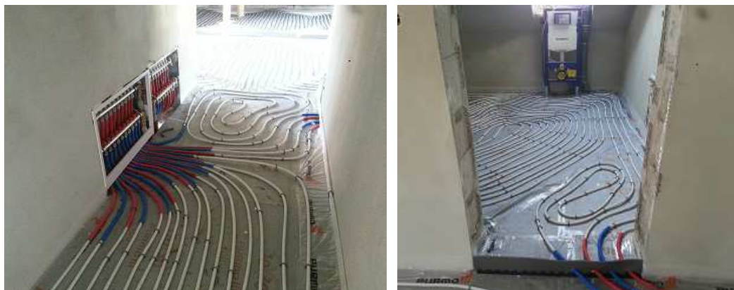
Fot. 5. Instalacja ogrzewania podłogowego
