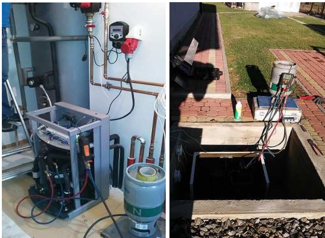
Fot. 4. Napełnianie układu czynnikiem chłodniczym oraz przykładowy sposób montażu pompy ciepła w studziencie na zewnątrz
